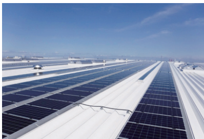
屋上や屋根を活用した自家消費型太陽光発電が拡大
