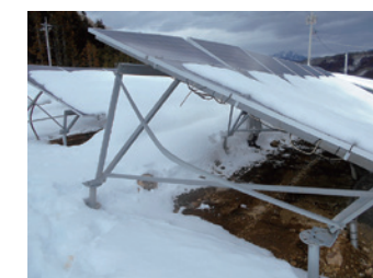
雪の重みに耐えられず、架台が曲がった事例
