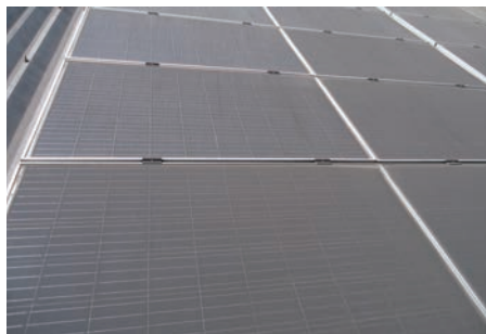
洗浄前の汚れたモジュール
