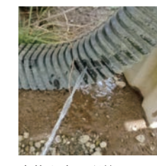
水抜き中の配管
