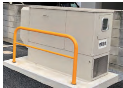
LPガス発電機本体
