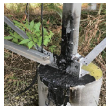
ケーブル焼損
