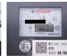
スマートメーターで確認
