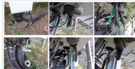
切断されたケーブル
