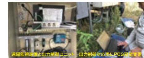
遠隔監視装置と出力制御ユニット、出力制御対応時にPCS設置変更
